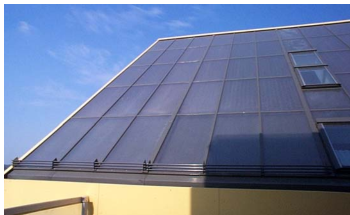
Bild 2: Solardach mit integrierten Dachfenstern und Blindelementen ohne Absorber in zeitweise verschatteten Bereichen
