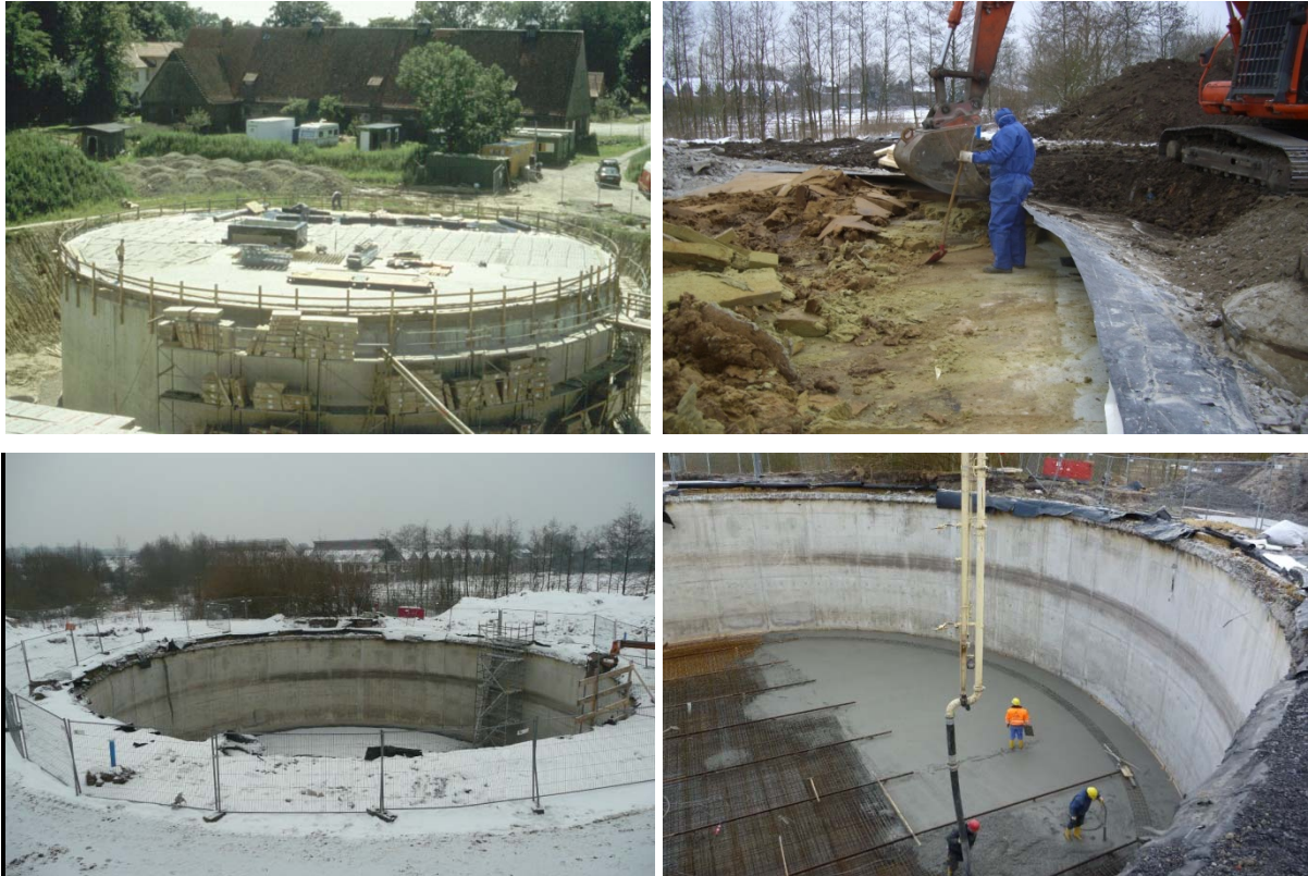
Bild 3: Fotos des Speichers; oben links: Bau des ursprünglichen Betonbehälters (1996), oben rechts: entfernen der oberen Schutzbetonschicht und der Wärmedämmung, unten links: Behälterwand mit bereits verfülltem unteren Kegelstumpf, unten rechts: Betonieren der neuen Bodenplatte
